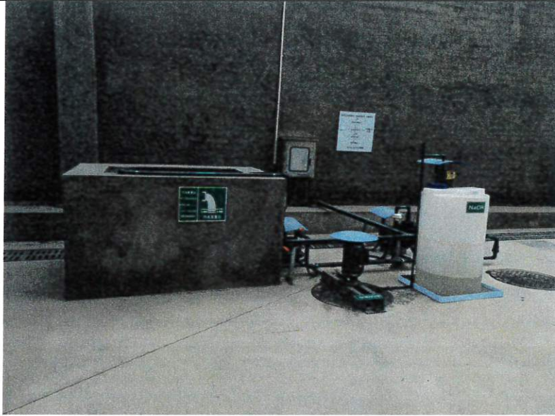
图 3.1-2 废水处理设施照片
