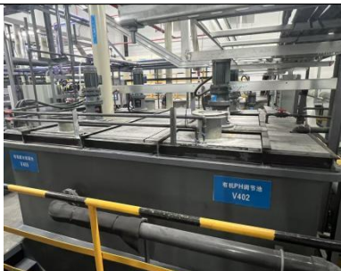
有机废水处理系统 (TW003)
