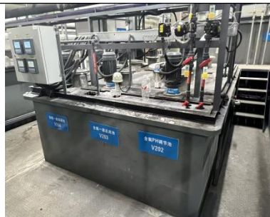
含氟废水处理系统 (TW001)
