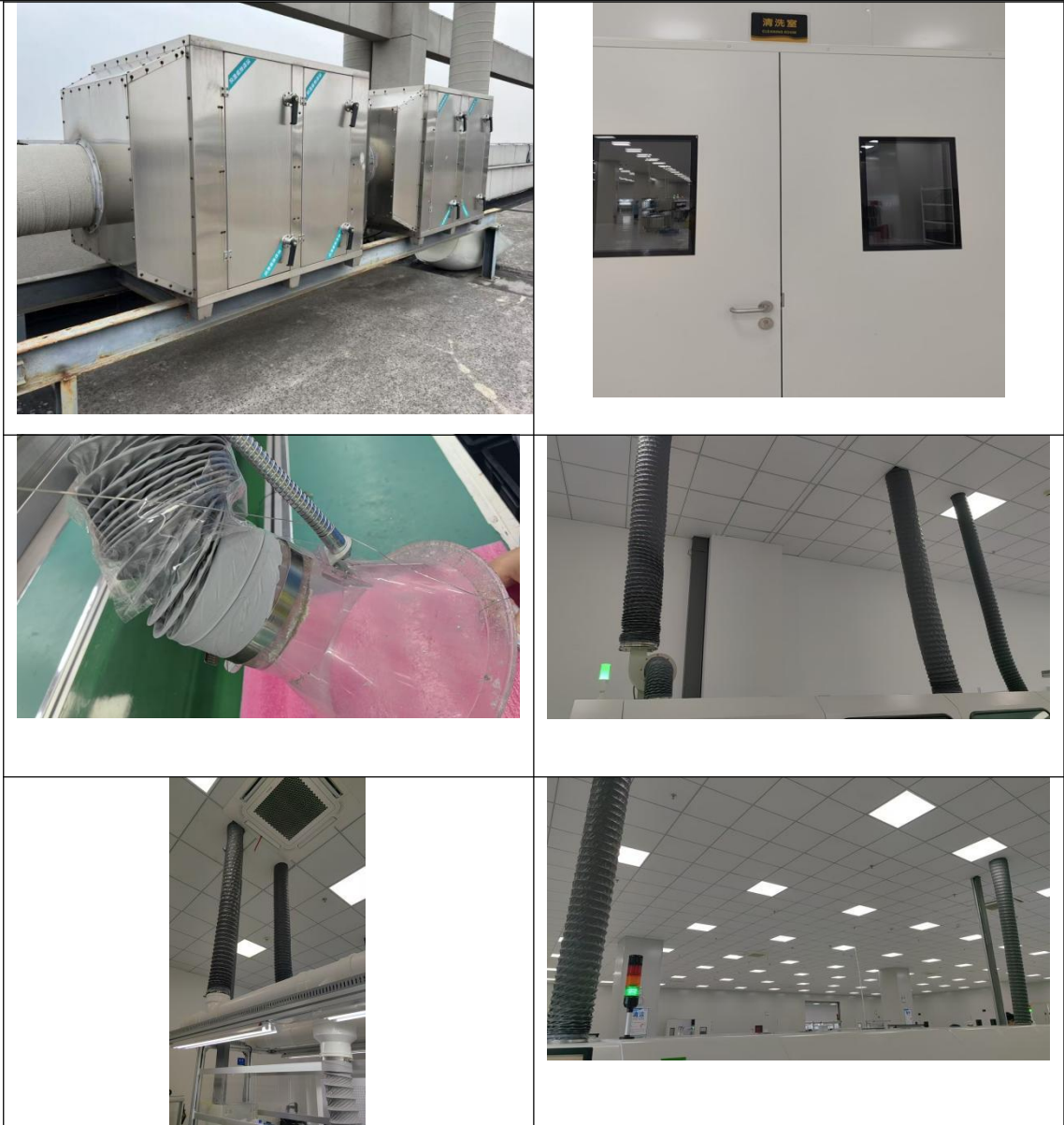
图 3-1 企业废气收集和处理装置
