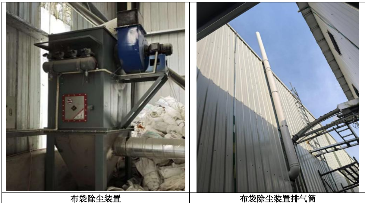
图 4.1.2-2 废气处理装置照片
